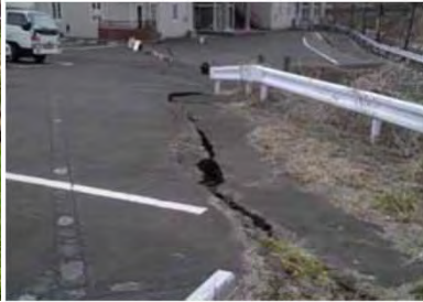
(b)のり肩の亀裂の事例
