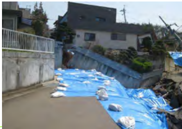
(c)腹付け盛土の崩壊の事例
