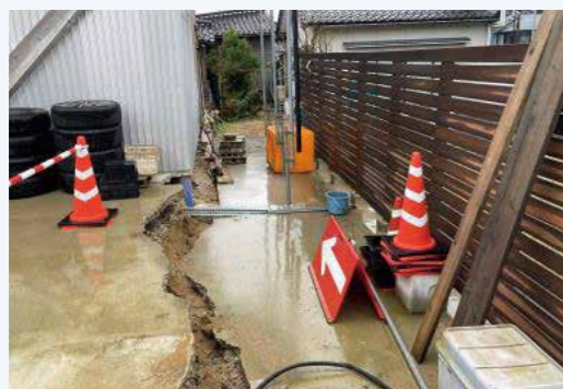
宅地の地割れ
