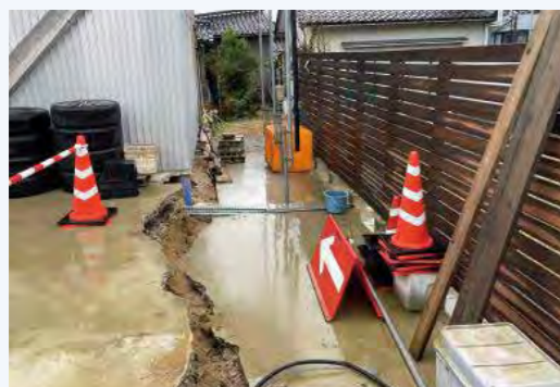
宅地の地割れ
