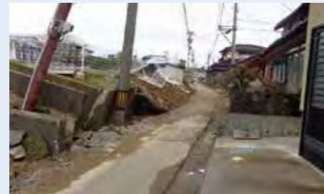
擁壁の転倒・崩壊
