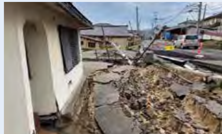
宅地の地割れ
