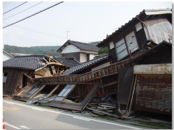
※写真：倒壊した住宅（平成 19 年能登半島地震）
