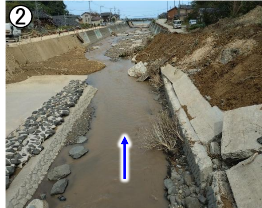
護岸の被災状況
