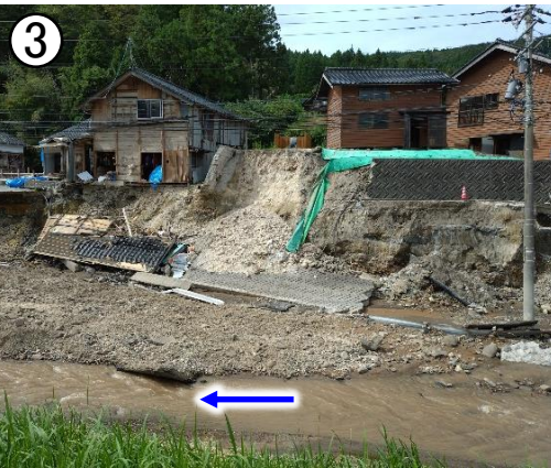
護岸の被災状況
