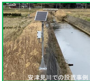
安津見川での設置事例
