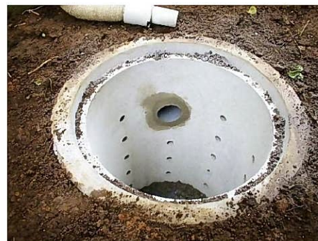
雨水浸透ます
