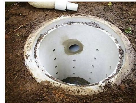
雨水浸透ます
