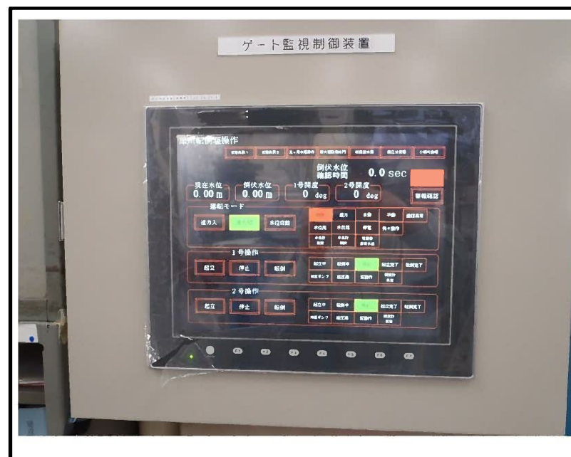
遠隔操作設備
