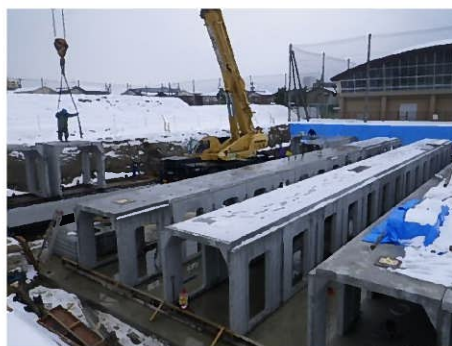
雨水貯留施設(地下貯留)
