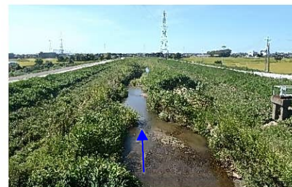
堆積状況 金腐川 (金沢市)
