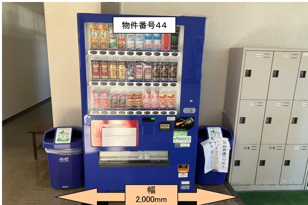
コンセント位置 物件44自動販売機後方
