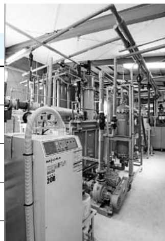
フロン類破壊装置
