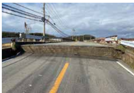
橋梁の段差 (国道249号 志賀町清水今江)
