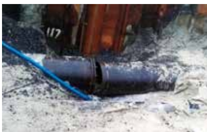
既設送水管の被災状況(継手の離脱)
