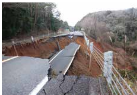
道路盛土の崩壊 (のと里山海道 徳田大津IC~横田IC)
