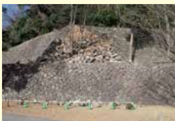
石垣の崩落（本丸南石垣）
