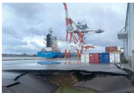
舗装の沈下(金沢港 御供田ふ頭)
