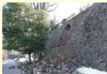
石垣の崩落（本丸北石垣）
