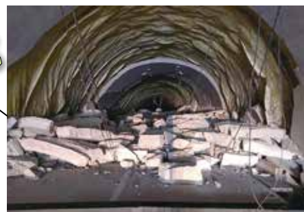
トンネルの損傷(国道249号 大谷トンネル)
