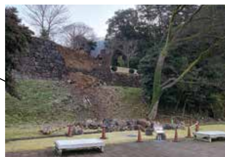
石垣の崩落(金沢城公園)
