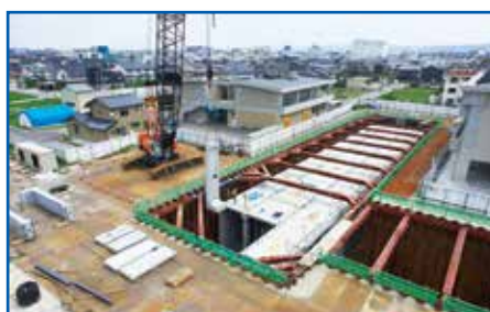
雨水貯留施設（金沢市 鞍月小学校）
