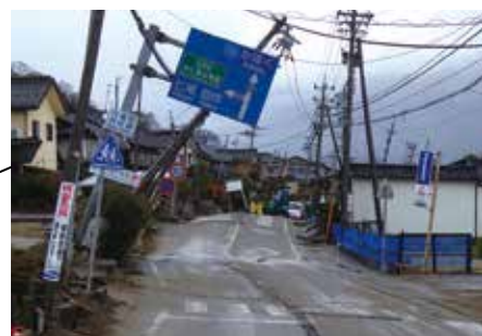
液状化 ((主)松任宇ノ氣線 内灘町西荒屋)
