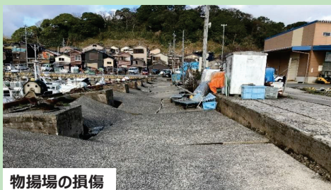
物揚場の損傷
