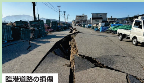
臨港道路の損傷
