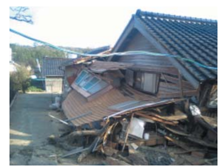
住宅被害状況
