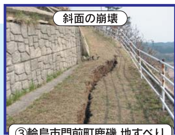
③輪島市門前町鹿磯 地すべり
