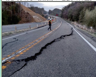
被災状況（路面の亀裂・段差）
