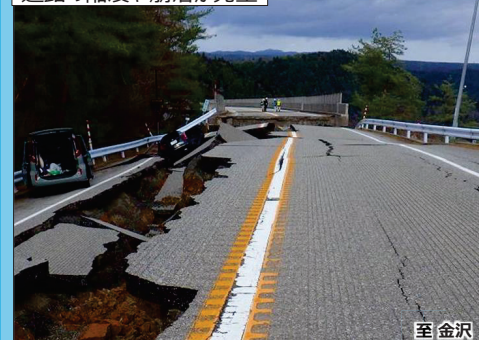
道路の陥没や崩落が発生
