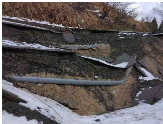
浄水場から配水池へ向かう水道管の破損・露出
