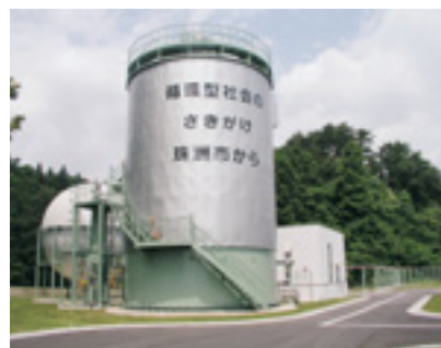
珠洲市浄化センター
