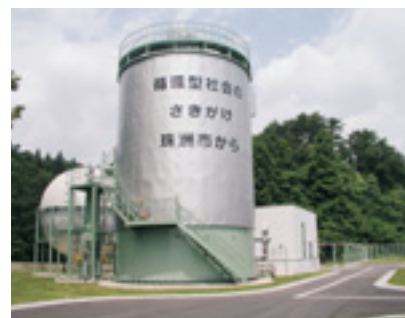
珠洲市浄化センター
