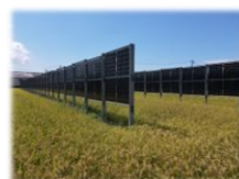
▲垂直型太陽光発電設備
