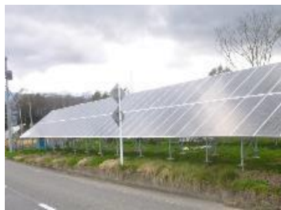
柵塀の設置されない設備
