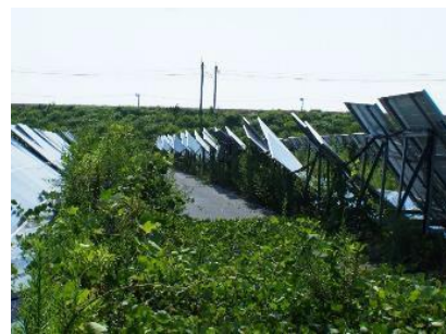
不十分な管理で放置されたパネル
