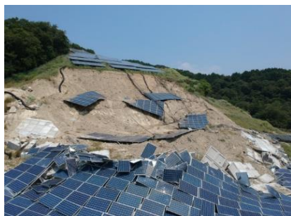
土砂崩れで生じた崩落
