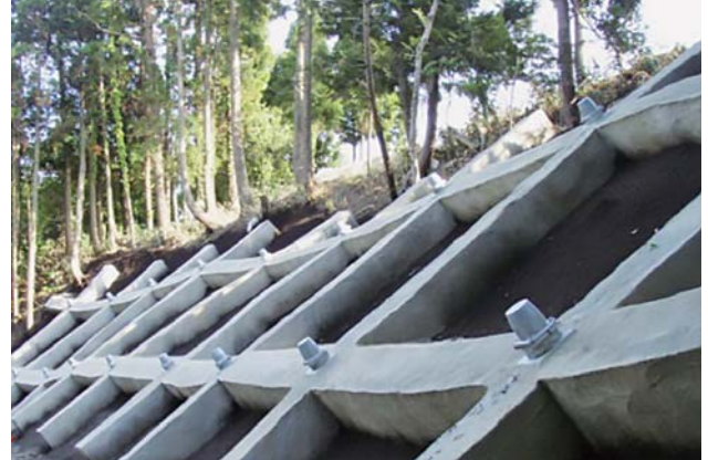
地すべり防止用アンカー
