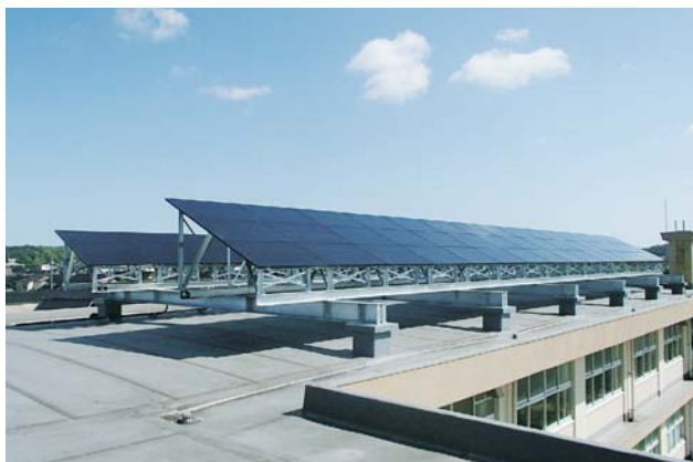
県有施設に設置した太陽光パネル
