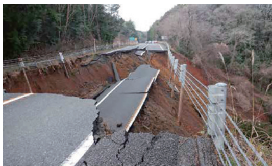
崩落したのと里山海道
