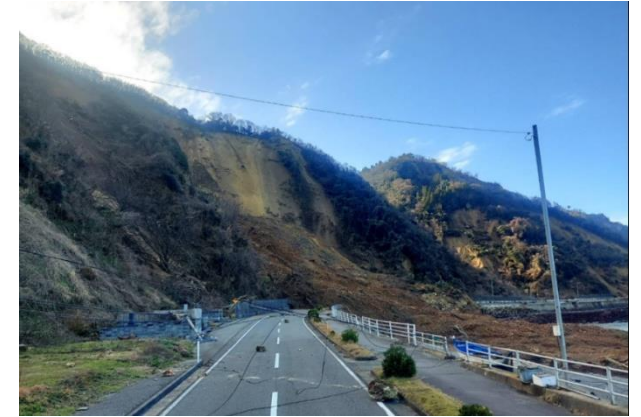
大規模法面崩落による主要道路の封鎖
