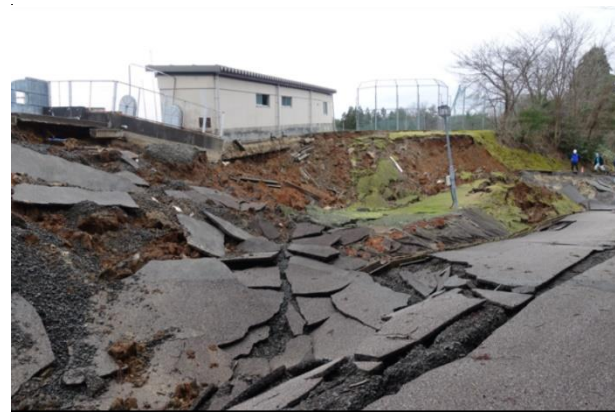
公共施設（上は穴水高校）近くの土砂崩れ
