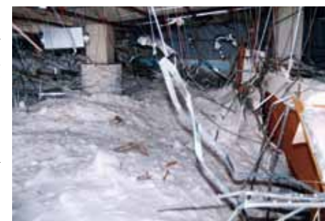
中宮展示館雪崩災害 (1996年2月) 展示館内部の被災状況
