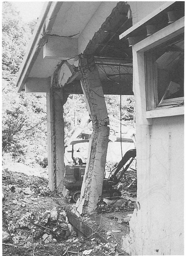
写真3 雪崩により完全に折れた柱 (1996年6月18日撮影)
