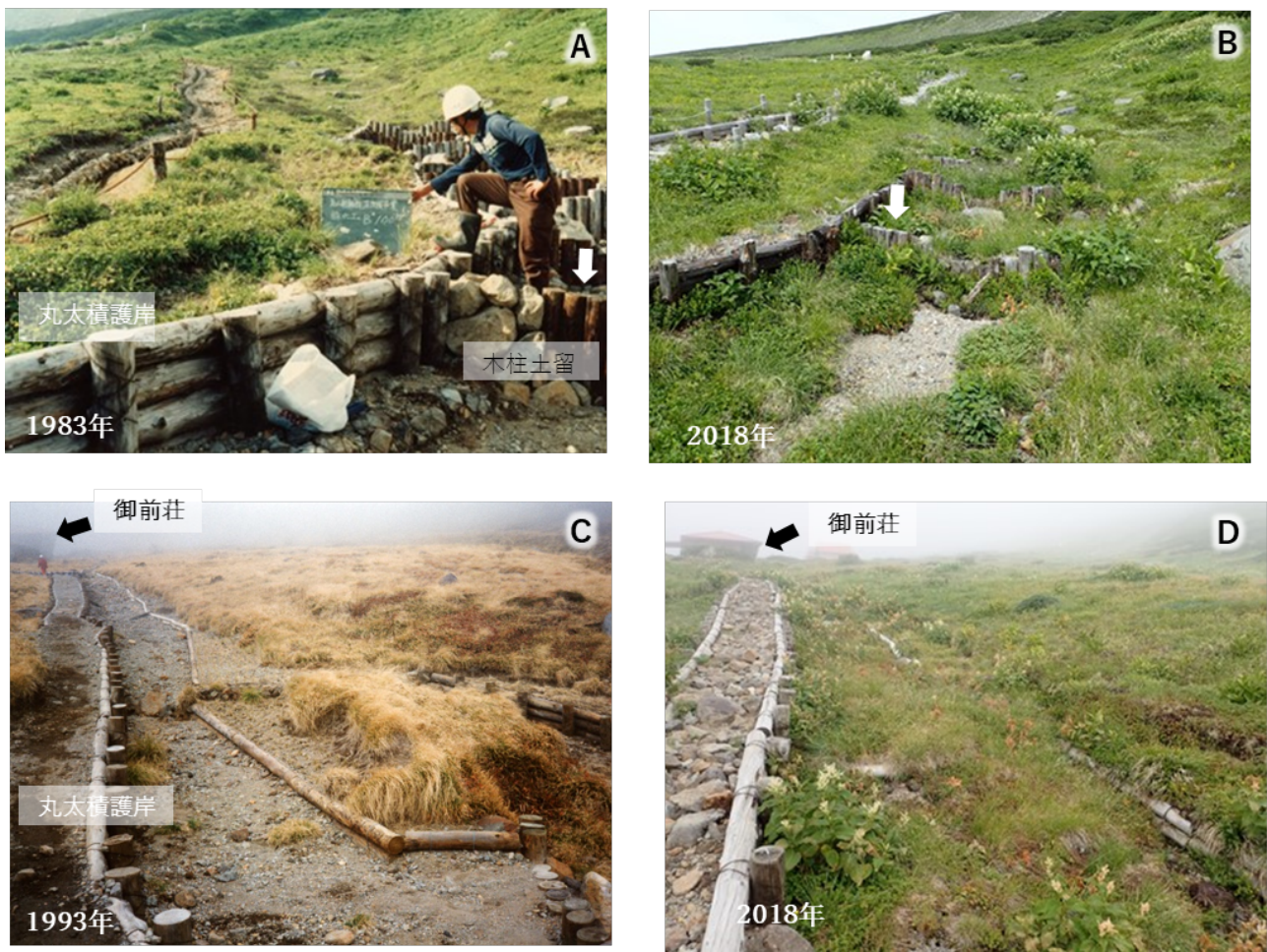
図8 調査区24, 25における木製構造物による溪流の荒廃修復状況
