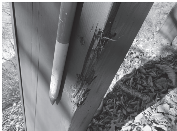
写真4 塗装中の10月発生被害
