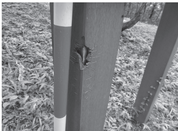
写真2 田島城の案内看板被害
