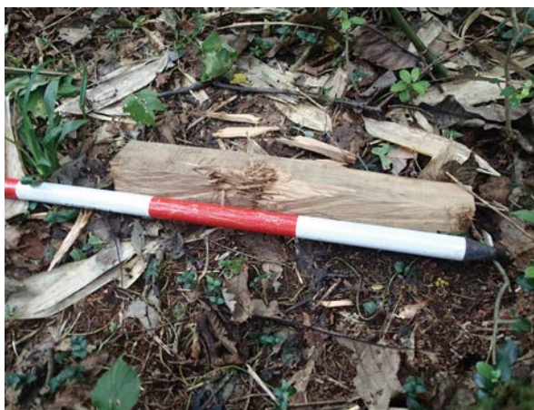
調査材料被害状況 3 (R3 8月：しがらくび付近)
