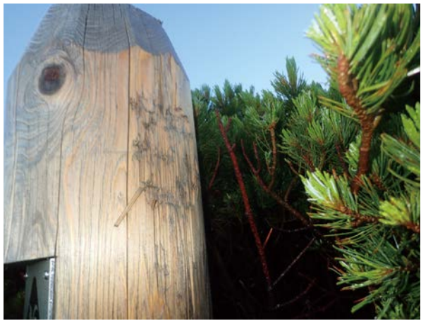
中宮道無垢材被害状況（R3 8月）H28 設置
