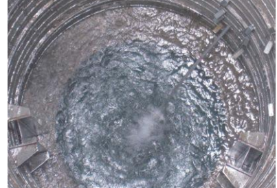
集水ボーリングから立坑内に 水が勢いよく排水されている
