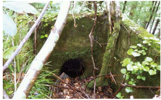
写真4 自家用水力発電に使っていた貯めマス導水管の穴が見える。
