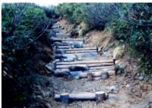
段差が大きくならないように、石及び丸太階段等を細かく配置した（砂防新道）
