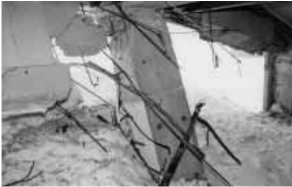
折れてしまったコンクリート製の柱
