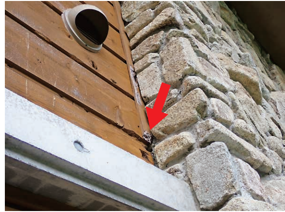
写真3 センター外壁の穴（赤矢印）
