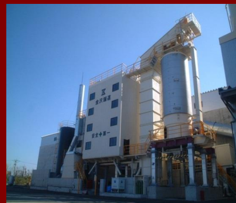
アスファルトプラント
