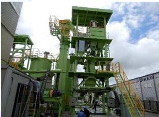
【材料攪拌装置】
