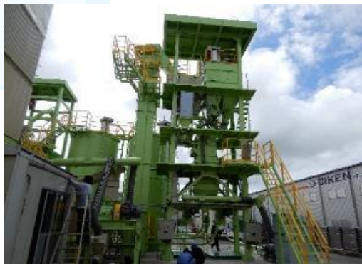
【材料攪拌装置】
