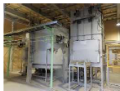
<Li-ion電池リサイクル設備>
