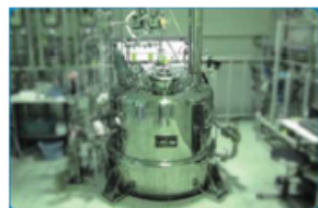
<バイオマスプラスチック製造設備>
