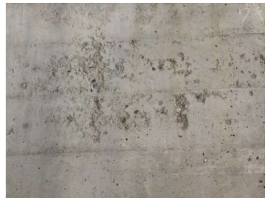
剥離が発生（鋼製スライドセントル）
