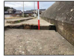
【石崎海岸】 天端の沈下
