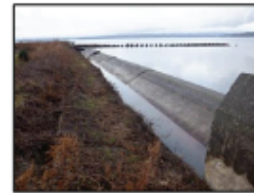
【能登島海岸】 堤防の倒伏
