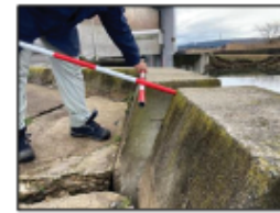
【和倉海岸】 堤防の傾斜
