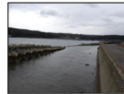
【穴水海岸】 消波工の沈下
