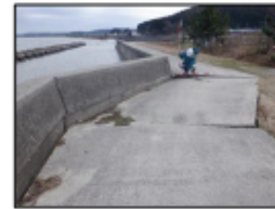
【田鶴浜海岸】 天端の沈下
