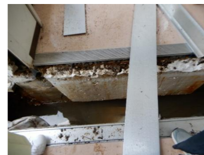
建物連結部の損傷
