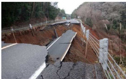
<道路崩落(のと里山海道)>
