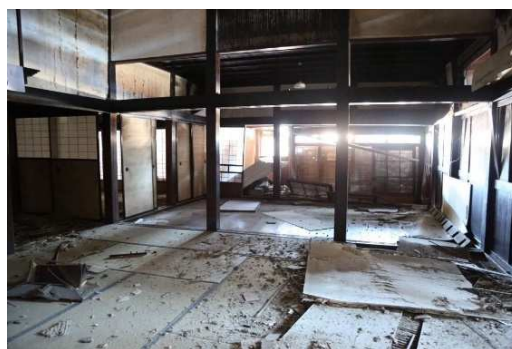
<中谷家住宅(能登町)主屋内部の被害>
