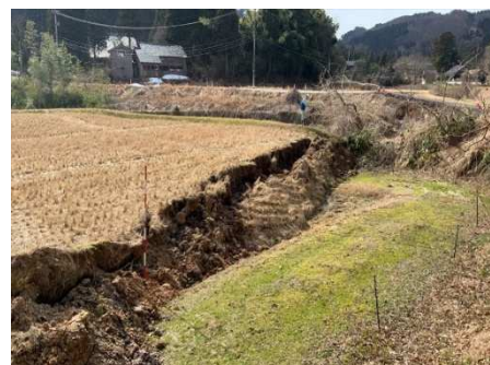
<農地の地割れ(珠洲市若山町中)>
