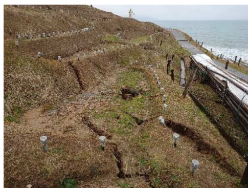
<白米千枚田(輪島市) ひび割れ>
