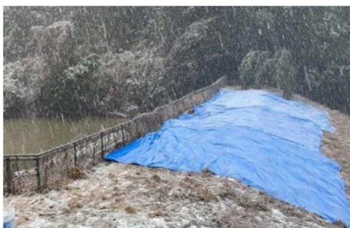
<ため池堤防の崩壊(輪島市小伊勢町)>
