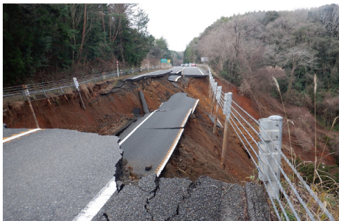
<道路崩落(のと里山海道)>
