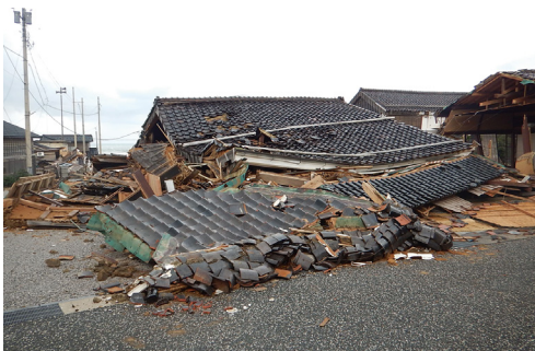
< 旧角海家住宅(輪島市)の被害 >
