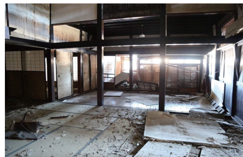
< 中谷家住宅(能登町)主屋内部の被害 >
