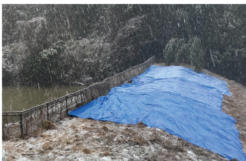
<ため池堤防の崩壊(輪島市小伊勢町)>
