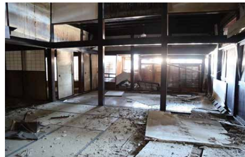
＜中谷家住宅(能登町)主屋内部の被害＞
