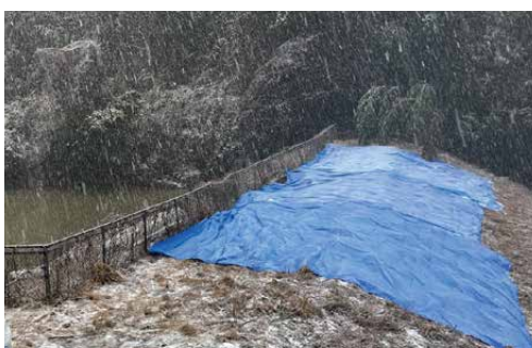
<ため池堤防の崩壊(輪島市小伊勢町)>
