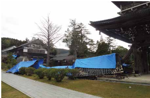
＜總持寺祖院(輪島市)の被害＞
