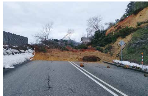
<道路寸断(珠洲道路)>
