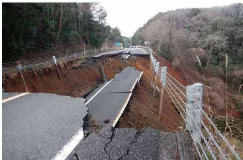
<道路崩落(のと里山海道)>
