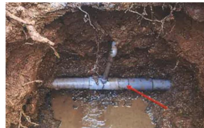
破断した水道管
