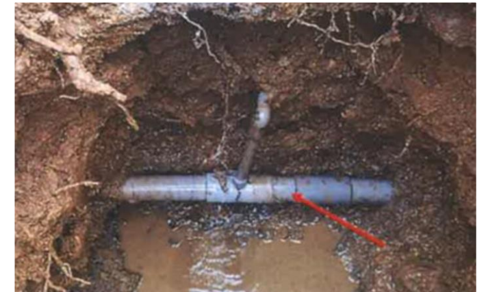
破断した水道管
