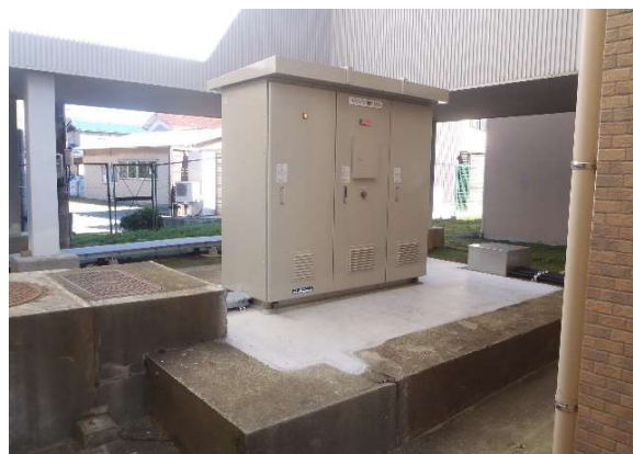
大聖寺高校 蓄電池設備
