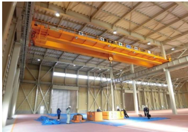
天井走行クレーン部
