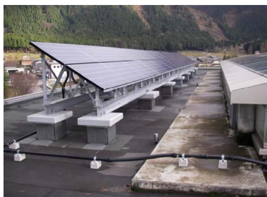
ふれあい昆虫館 太陽光発電設備
