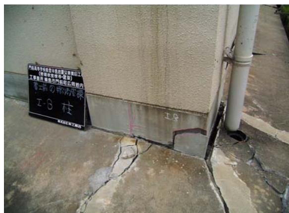
柱脚部分の破損状況
