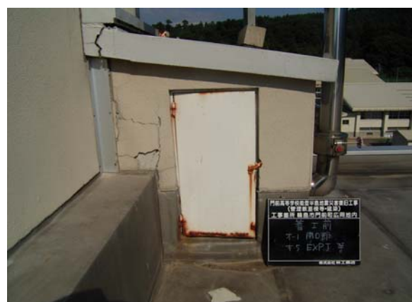
開口部、エキスパンションジョイントの被害状況
