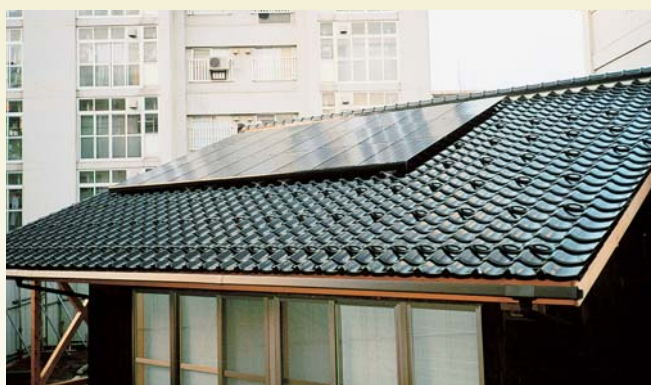
集会所 太陽光パネル設置
