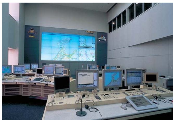
警察本部庁舎 通信指令室
